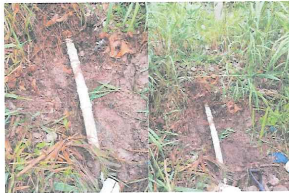
Fuga en tubo de 2" en calle de la luz en el mes de noviembre.
