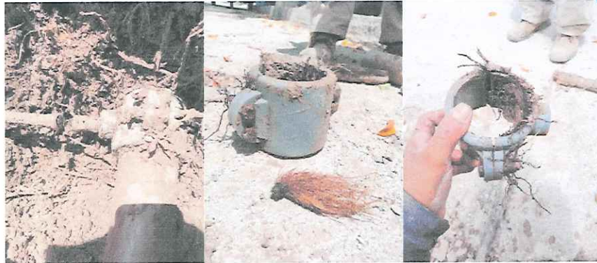
Toma obstruida en contrato 1714 en calle matamoros en barrio de san José en el mes de octubre.
