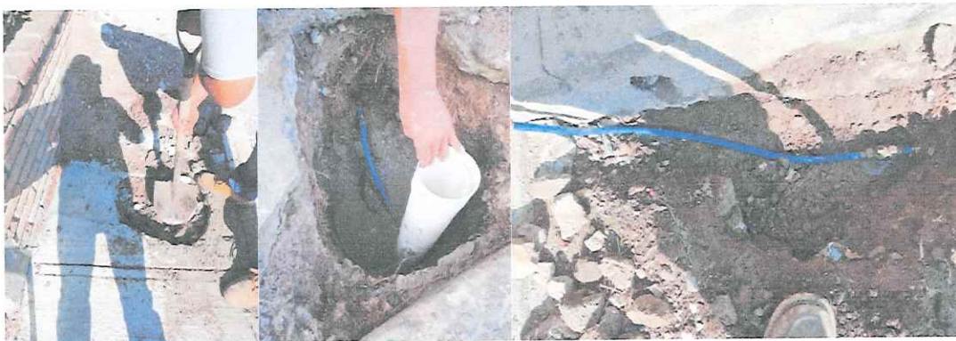
Fuga en llave de banqueta en calle zafiro con contrato 1861 en el mes de octubre.
