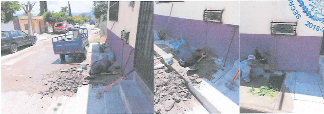
Fuga en llave de banqueta en contrato 2808 en calle matamoros en barrio de san José en el mes de junio.
