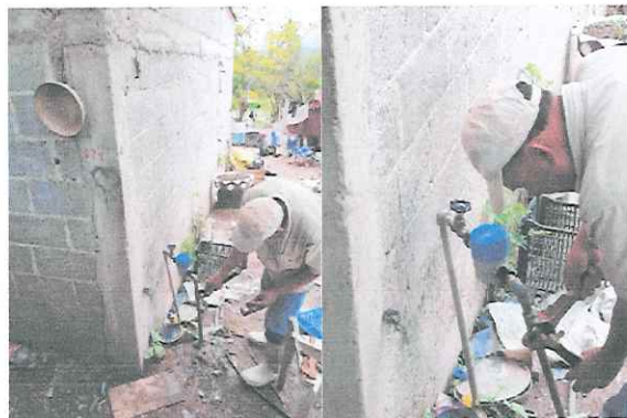
Fuga en cuadro de medidor en contrato 874 en calle González bocanegra en el mes de noviembre.
